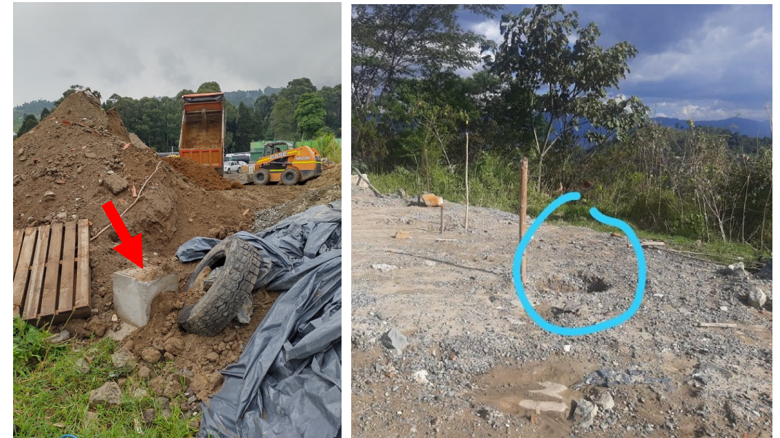
Figura 4. Imagen izquierda: actividades industriales cerca al inclinómetro monitoreado. Imagen derecha sepultamiento del inclinómetro.
