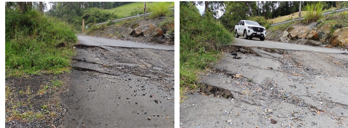
Figura 4. Afectaciones en vía vehicular, fotografía izquierda tomada el 27 de julio de 2021 y la fotografía derecha toma el 1 de octubre de 2021.
