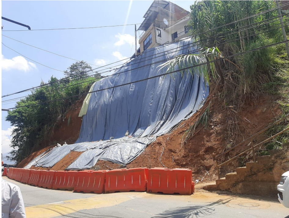
Figura 1. Talud afectado en el barrio Villatina (comuna Villa Hermosa) en la calle 52 con carrera 15.
