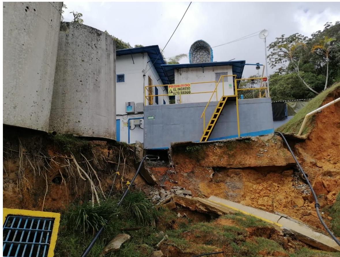
Figura 13. Afectaciones en el acceso al acueducto de la vereda San José
