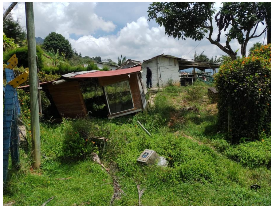
Figura 15. Colapso de casa construida en madera
