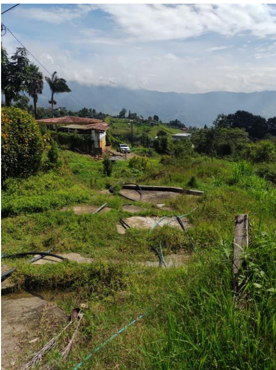
Figura 14. Afectaciones en el acceso al acueducto de la vereda San José
