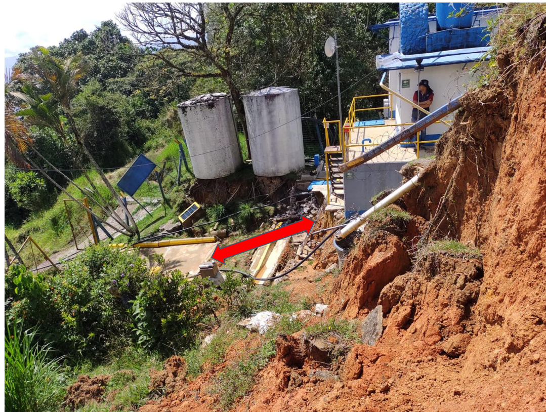
Figura 18. Talud de los tanques afectado.
