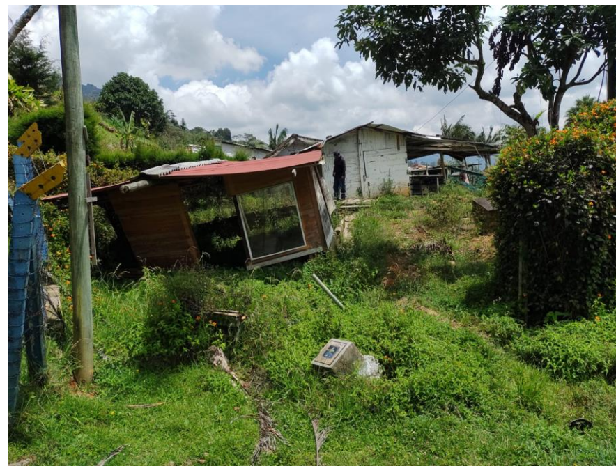
Figura 15. Colapso de casa construida en madera
