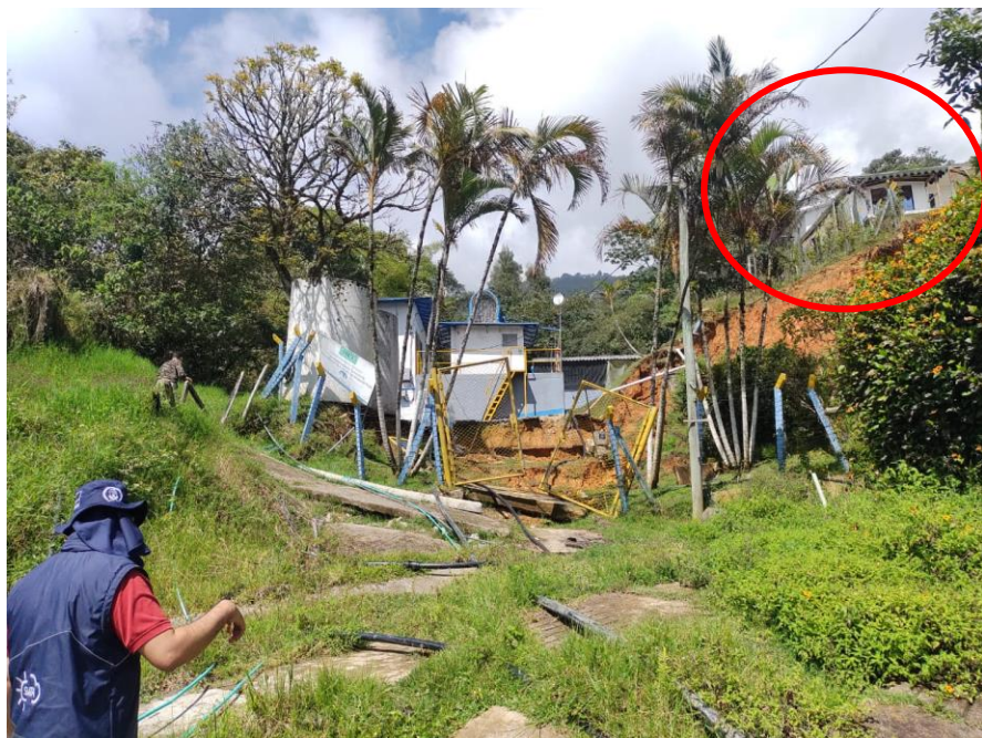
Figura 17. Afectación del talud cerca de la casa que se encuentra señalada con un círculo rojo.
