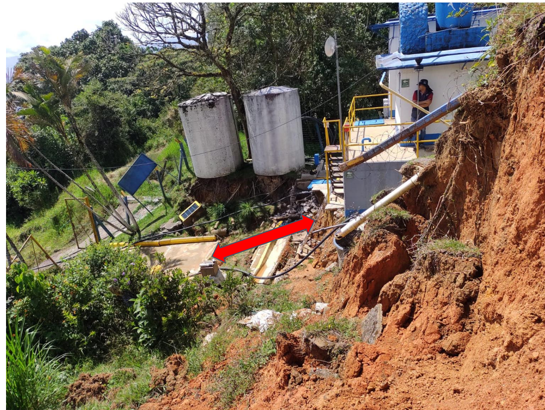
Figura 18. Talud de los tanques afectado.
