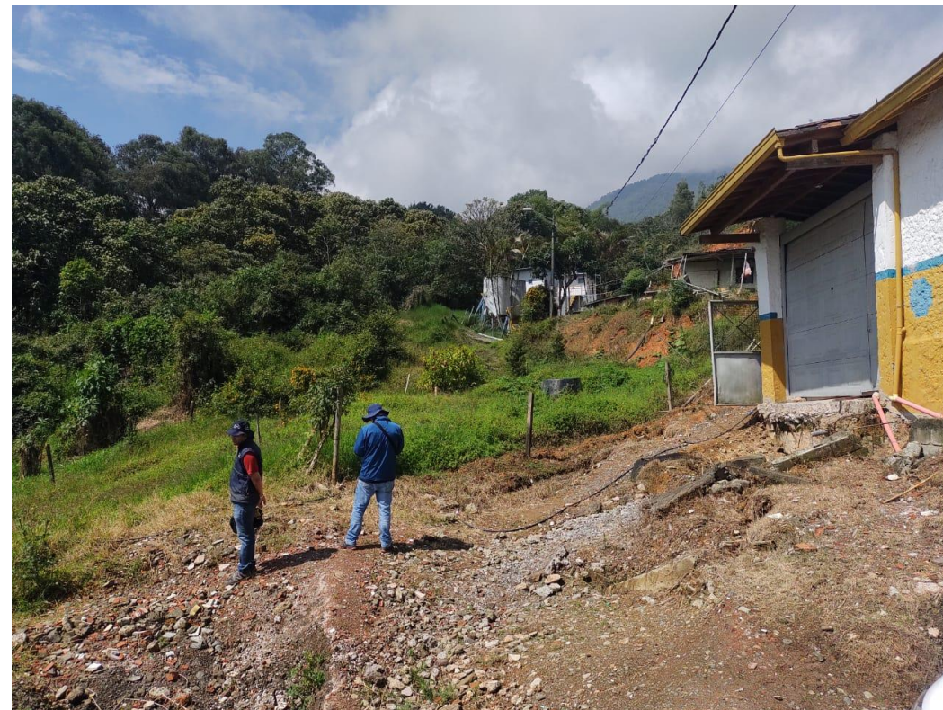
Figura 16. Desplazamiento relativo de losa de acceso
