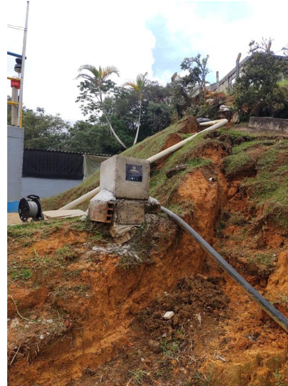
Figura 8. Deformaciones del terreno cerca al inclinómetro VLF INC-02.
