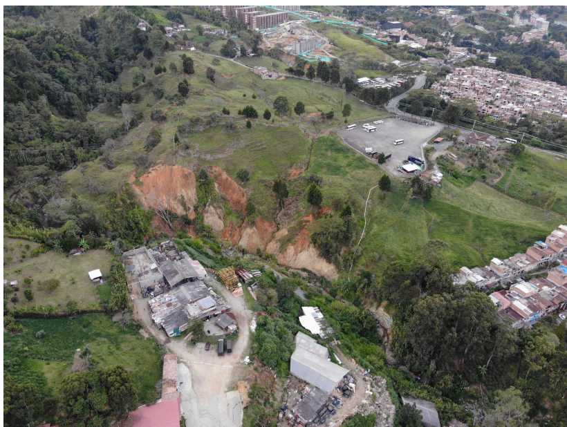
Figura 4. Fotografía panorámica de drones a deslizamientos y agrietamientos del terreno en el predio adyacente al parqueadero Los Cañazos. Estos deslizamientos depositan material a la quebrada La Limona.
