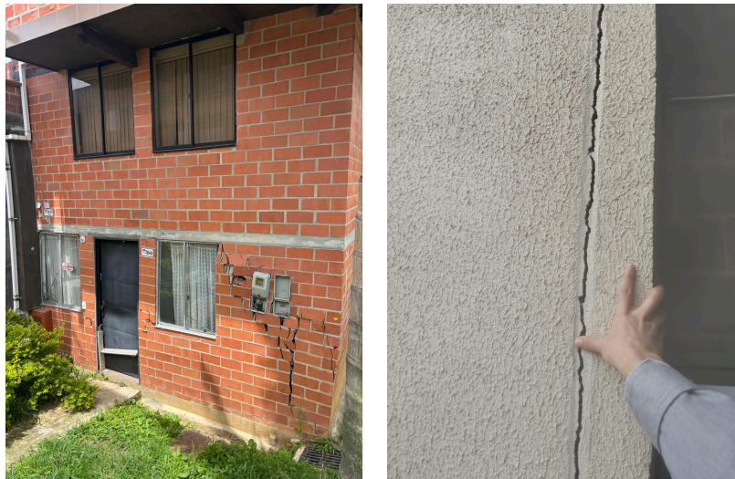
Figura 3. Fotografía izquierda, patologías estructurales (agrietamientos) en edificación del sector Prado Campestre. Esta y otras dos tres edificaciones contiguas están deshabitadas por riesgo de colapso, mientras que numerosas unidades residenciales vecinas tienen agrietamientos (más de diez), además de agrietamientos en losas de andenes peatonales del caserío. Fotografía derecha, agrietamientos en Unidad Residencial Piemonti.
