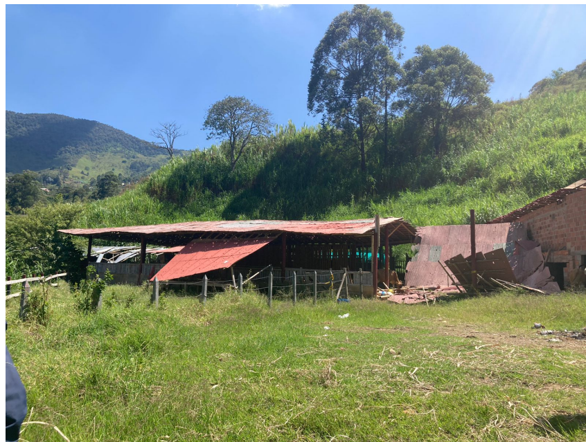
Figura 2: Estructuras afectadas dentro de la finca La Montana.
