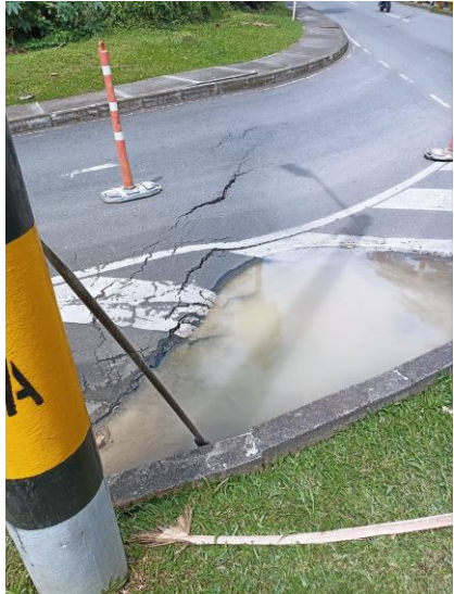
Figura 5. Agrietamiento en la vía y fuga de agua en tubería de EPM.
