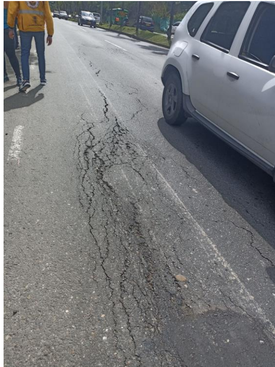
Figura 3. Agrietamiento y hundimiento en la calzada en dirección Medellín - Rionegro.
