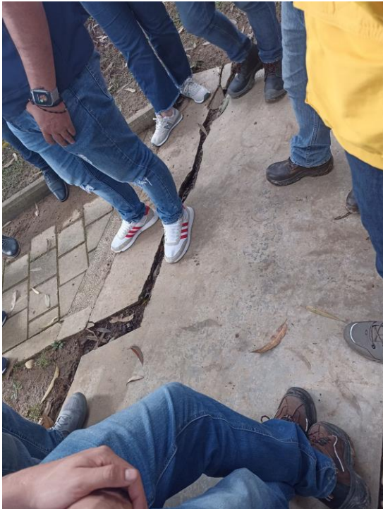
Figura 2. Agrietamiento en una estructura de concreto en la construcción contigua a la zona afectada.
