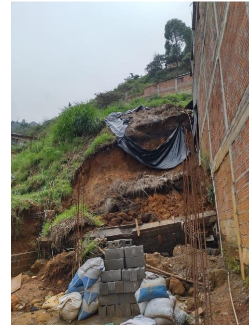
Figura 2. Deslizamiento en cota inferior al talud monitoreado
