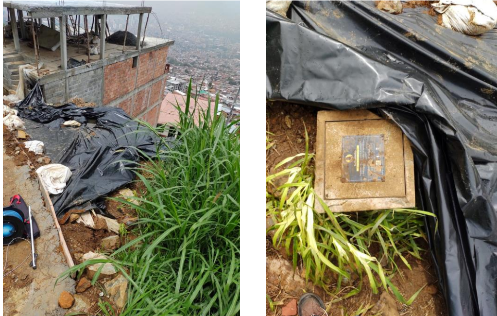
Figura 1. Imágenes de la caja del inclinómetro Brisas del Jardín cubierta por un plástico negro (izq) y visiblemente inclinada (der)
