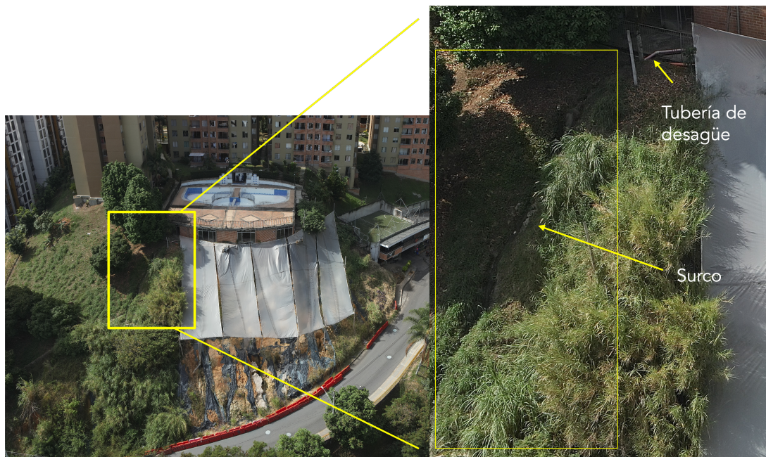
Figura 2: Foto panorámica sobre la zona del deslizamiento 2 de la unidad residencial Atavanza: Detalle de hallazgos en el terreno.
