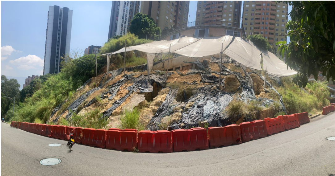
Figura 3: Foto panorámica sobre la zona del deslizamiento 2 de la unidad residencial Atavanza: condiciones generales.
