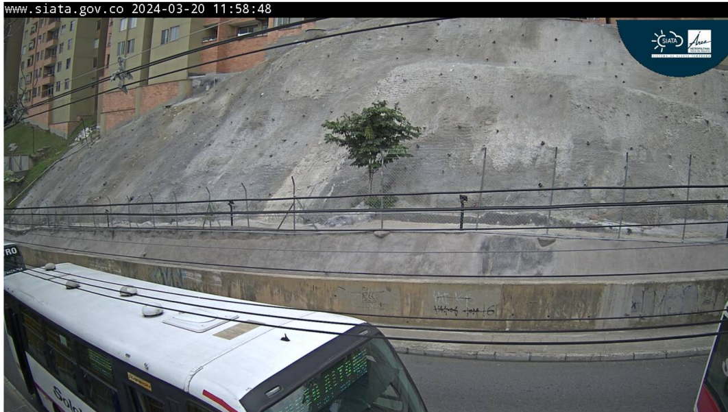
Figura 4: Registro fotográfico de deslizamiento 1, sector Atavanza.
