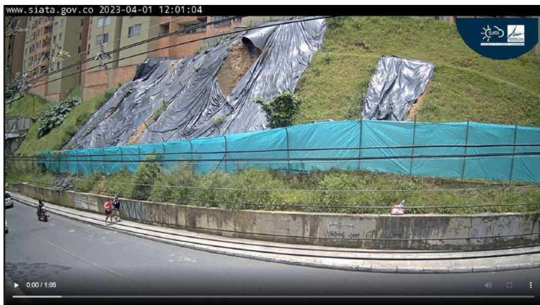
Figura 2: Visual cámara 100502. Sector Belén, urbanización Atavanza. Deslizamiento 1.
