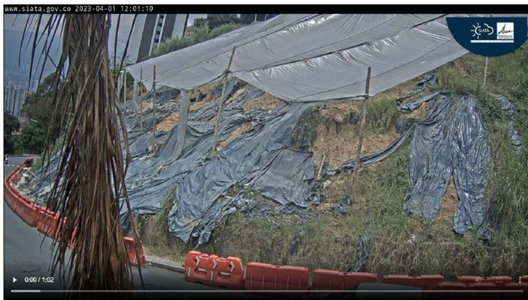
Figura 3: Visual cámara 100504. Sector Belén, urbanización Atavanza. Deslizamiento 2.
