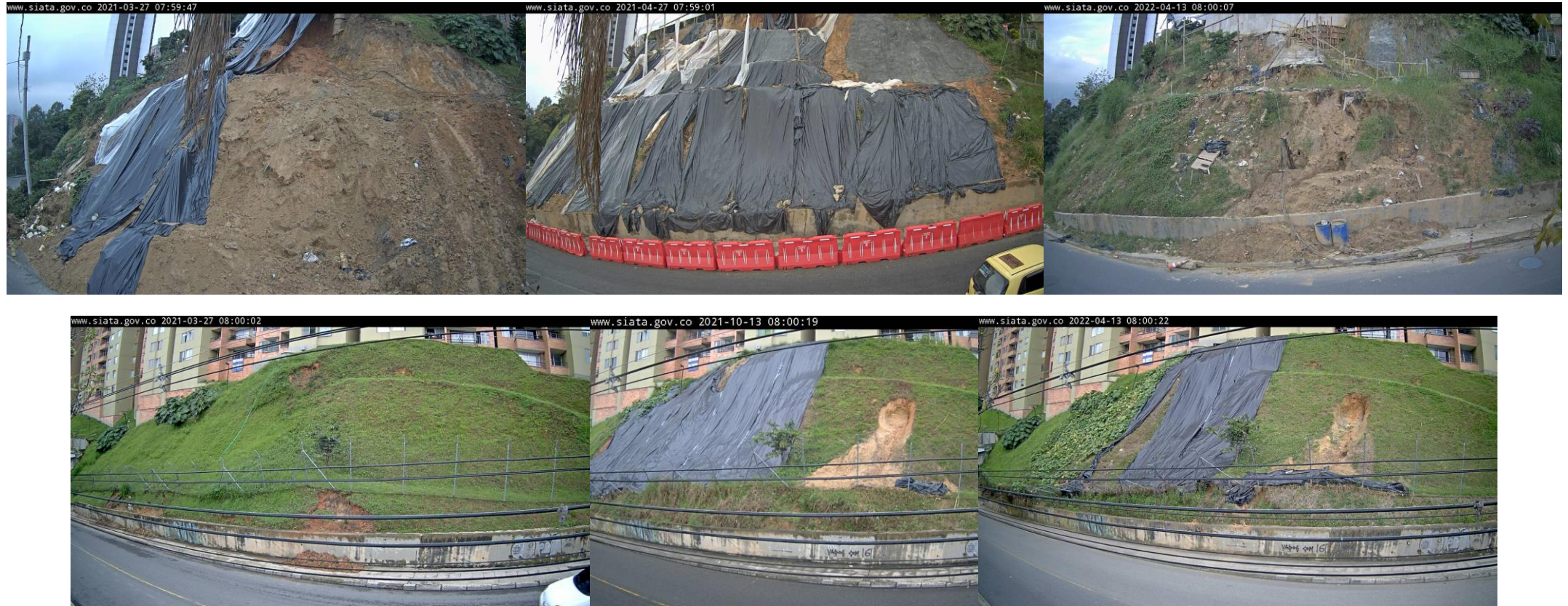
Figura 1 (figuras superiores): Cámara dirigida al talud afectado por la emergencia. Figura 2 (figuras inferiores): Cámara dirigida a talud con evidencias de inestabilidad.
