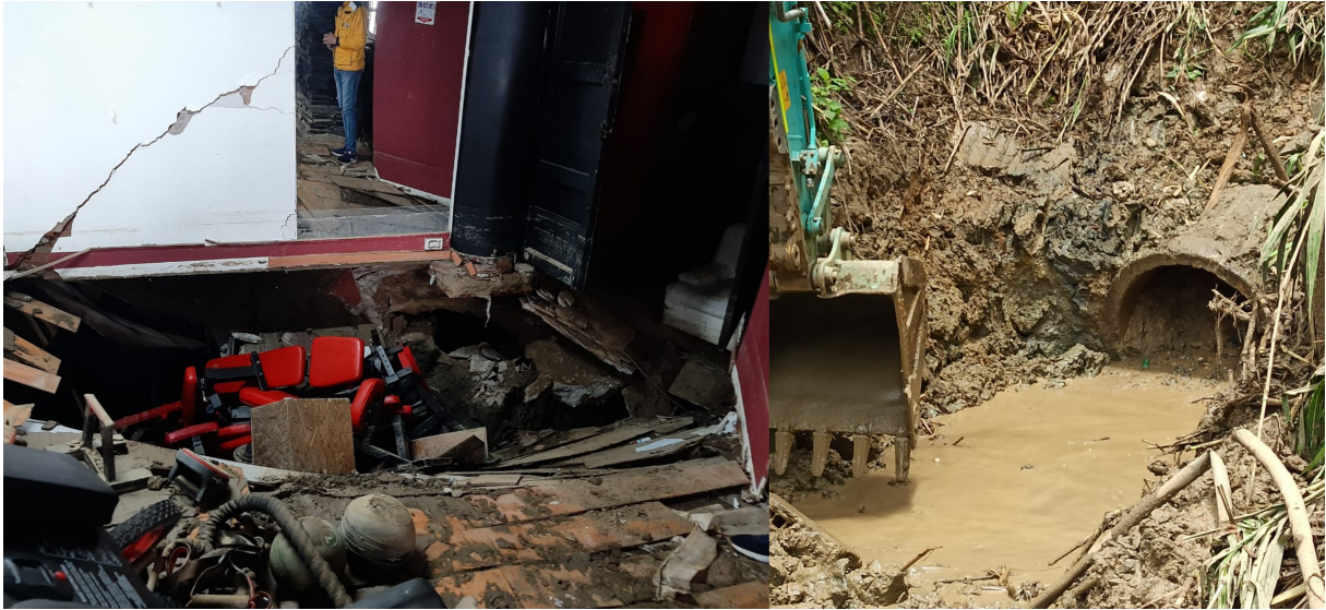
Figura 2: Izq: Imagen del estado de la estructura para el día 18 de septiembre de 2020. Der: Imagen del taponamiento del tubo identificado por la Secretaría de Medio Ambiente de la alcaldía de Medellín.
