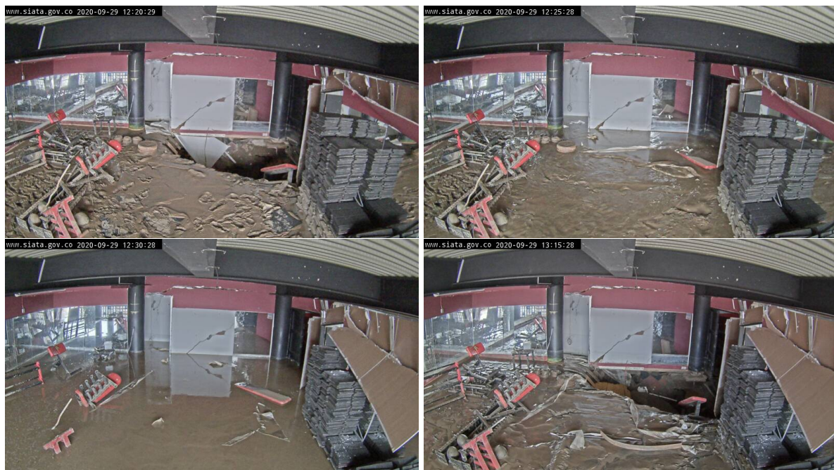
Figura 6: Cámara interna, registro fotográfico de la acumulación de agua en la zona afectada debido al evento de precipitación del día 29 de septiembre de 2020 entre las 12:20:00 a 13:20:00.
