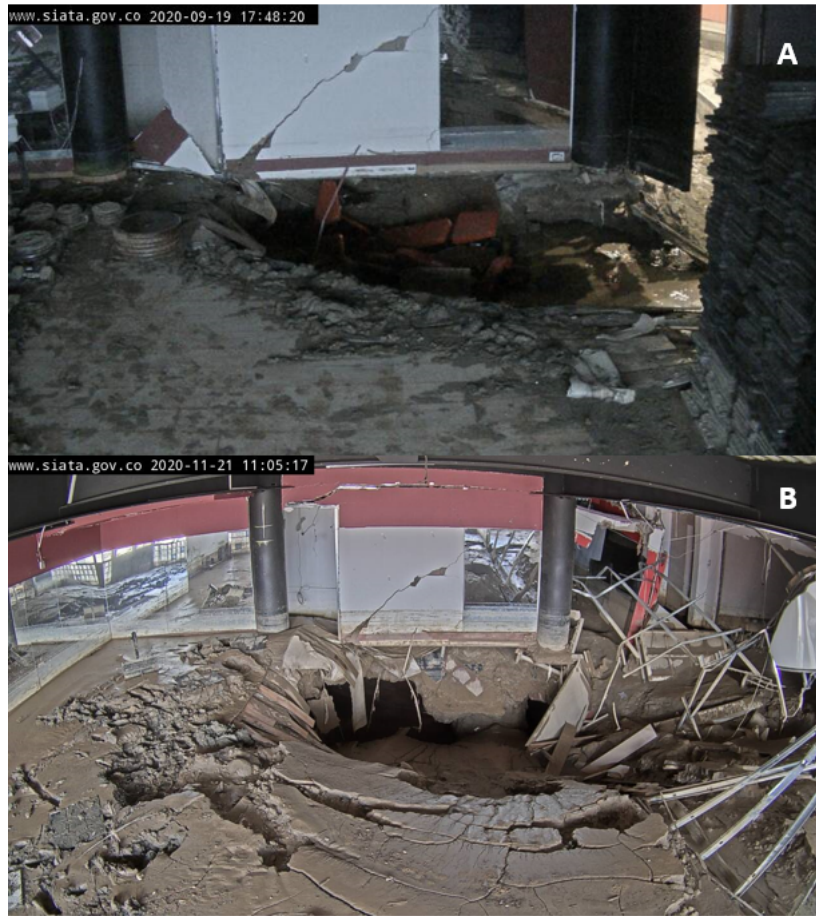
Figura 13: Cámara interna, registro fotográfico del estado de la estructura interna del gimnasio Animal X desde el 19/09/2020 (A) hasta el 21/11/2020 (B)
