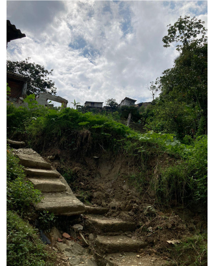
Figura 5c. Estructuras antrópicas afectadas.
