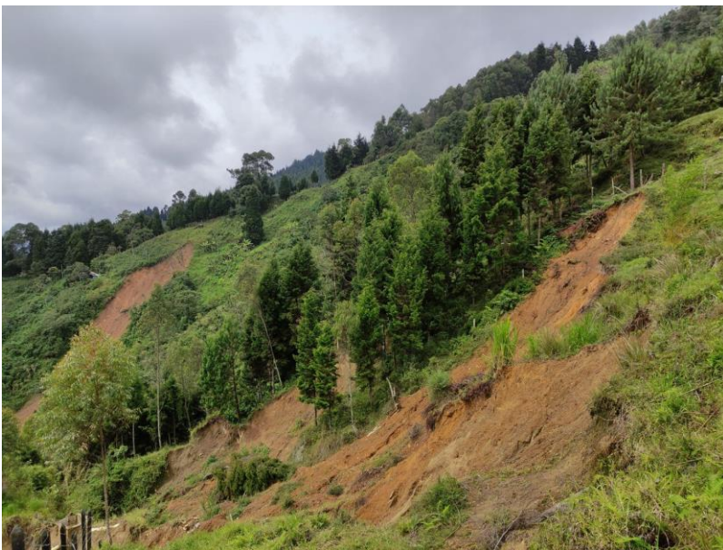
Figura 6. Afectaciones en el acceso al acueducto de la vereda San José
