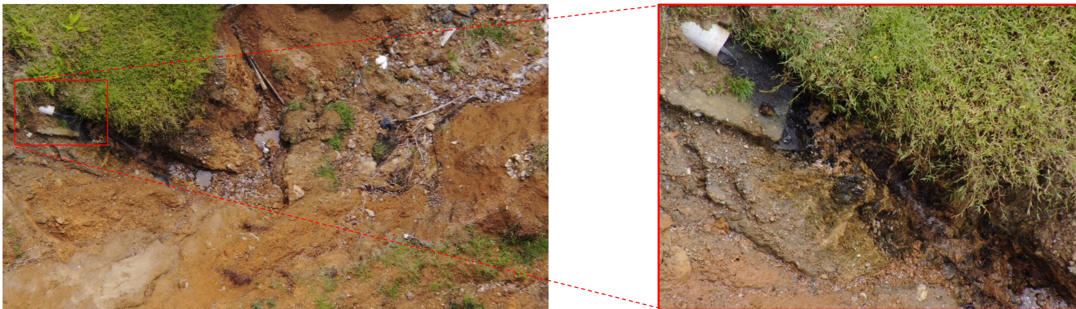
Figura 13. Salida de agua por medio de una tubería hacia la zona central del punto crítico 1.
