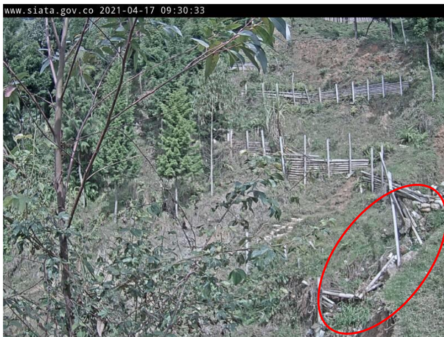
Figura 1. Captura de la cámara de monitoreo, dirigida hacia una de las cárcavas existentes. El área que se señala, muestra parte de las obras afectadas.
