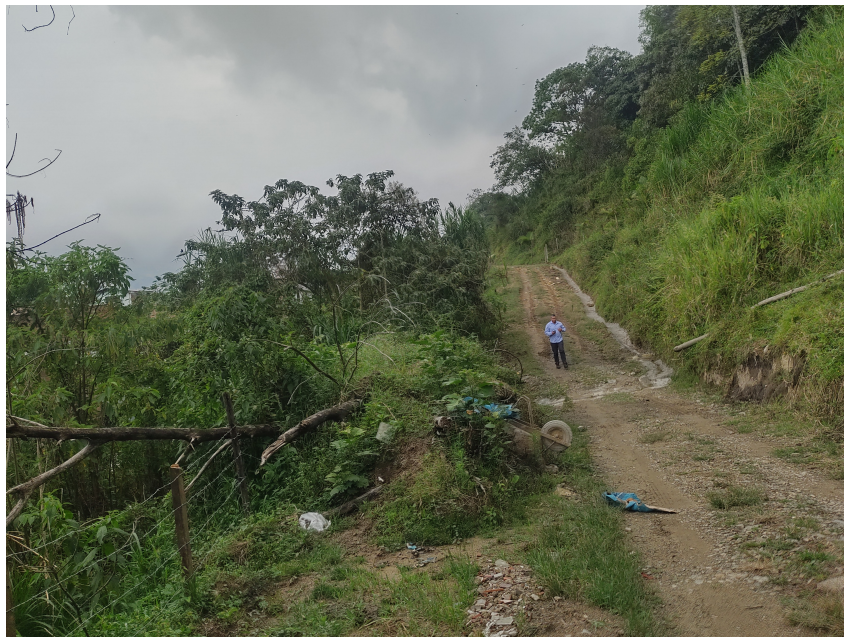
Figura 5: Material depositado en la vía vehicular. Fotografía tomada en marzo 10 de 2023, se removió el material de la vía vehicular.
