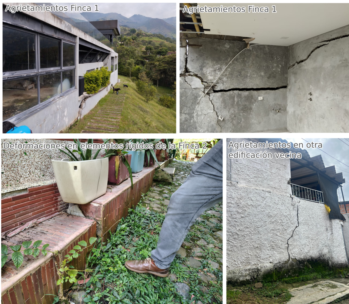
Figura 5: Afectaciones a edificaciones residenciales en la vereda El Zarzal.
