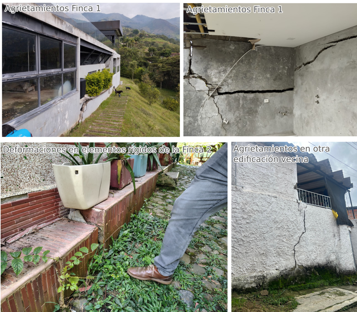
Figura 2: Afectaciones a edificaciones residenciales en la vereda El Zarzal.
