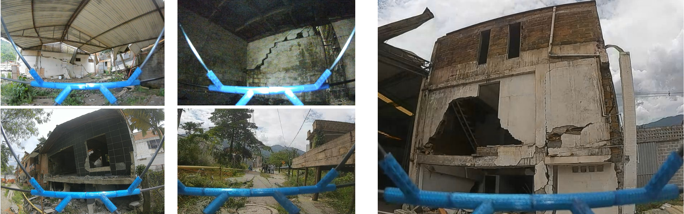
Figura 15. Sobrevuelo realizado el 24 de junio de 2022, con drones tipo FPV y de jaula, para ingresar en el sector a estructuras confinadas y en riesgo de colapso. El objetivo de esta solicitud fue hacer una evaluación previa al desmonte seguro de las edificaciones, e identificar rutas de ingreso.
