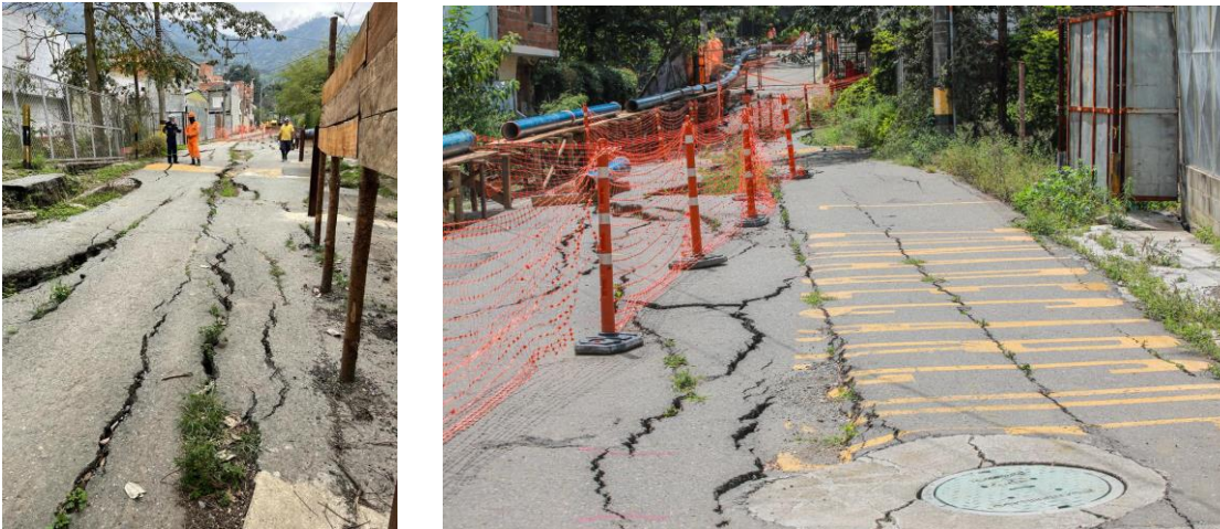
Figura 5. Estado de la vía sobre la zona afectada.
