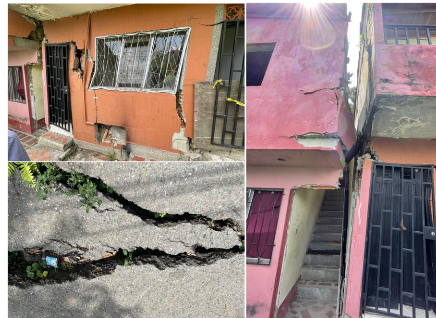
Figura 6. Avances en el deterioro de las viviendas y la vía de acceso evidenciadas en la visita de seguimiento realizada el 21 de octubre de 2021.
