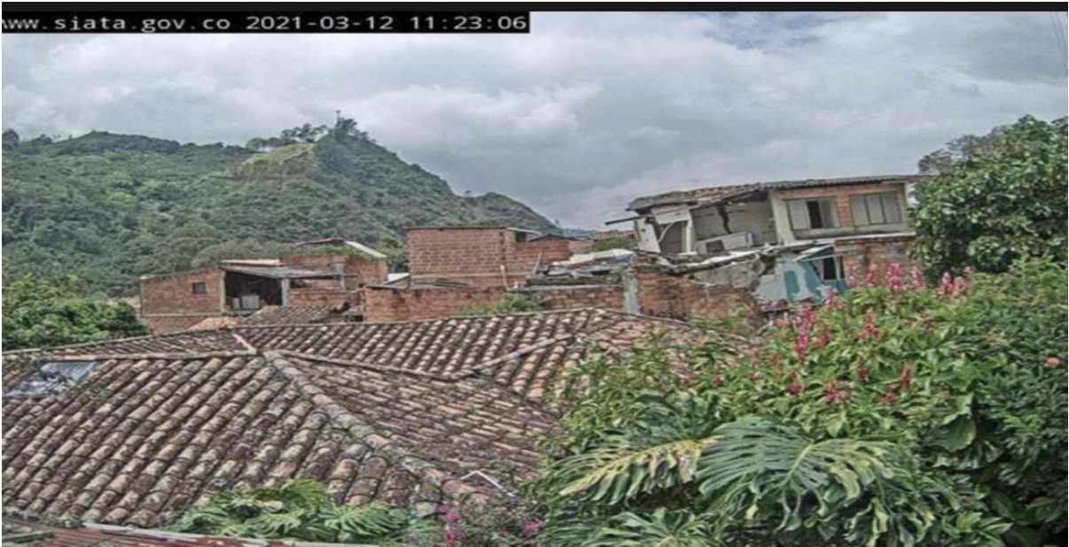
Figura 4. Estado a la fecha de algunas viviendas con riesgo de colapso monitoreadas en el sector.
