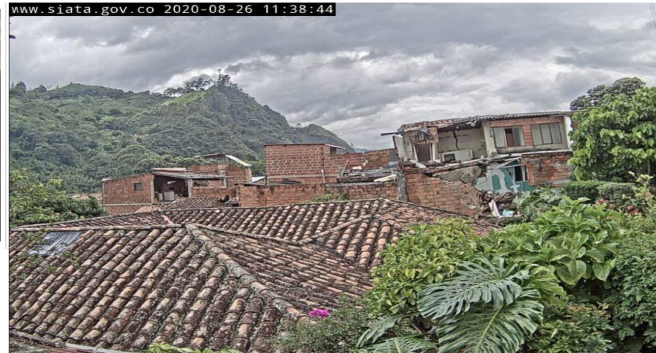
Figura 2. Estado de las viviendas después del colapso del muro.
