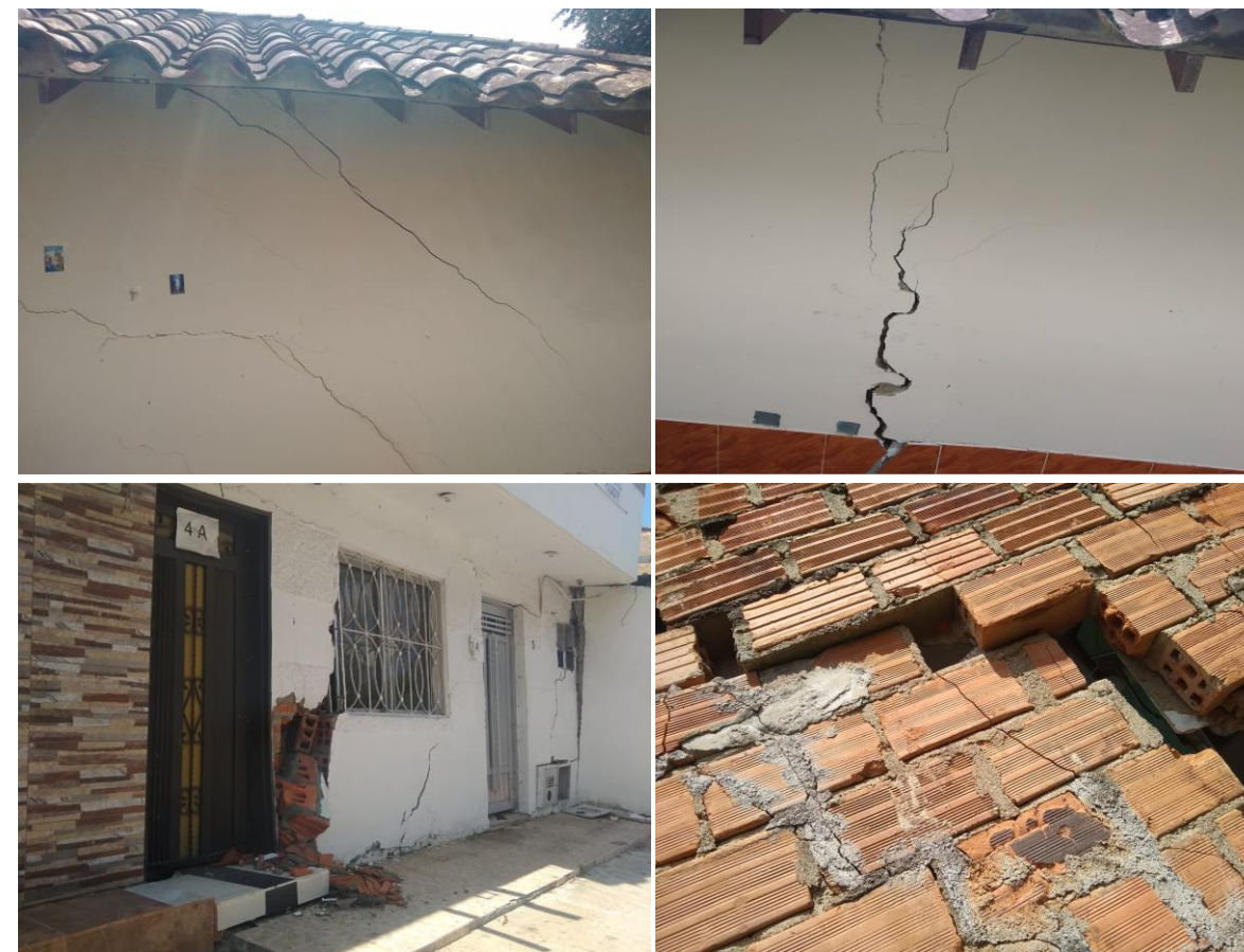
Figura 4. Estado de algunas viviendas en la visita de campo del 3 de julio de 2020 en la zona afectada.
