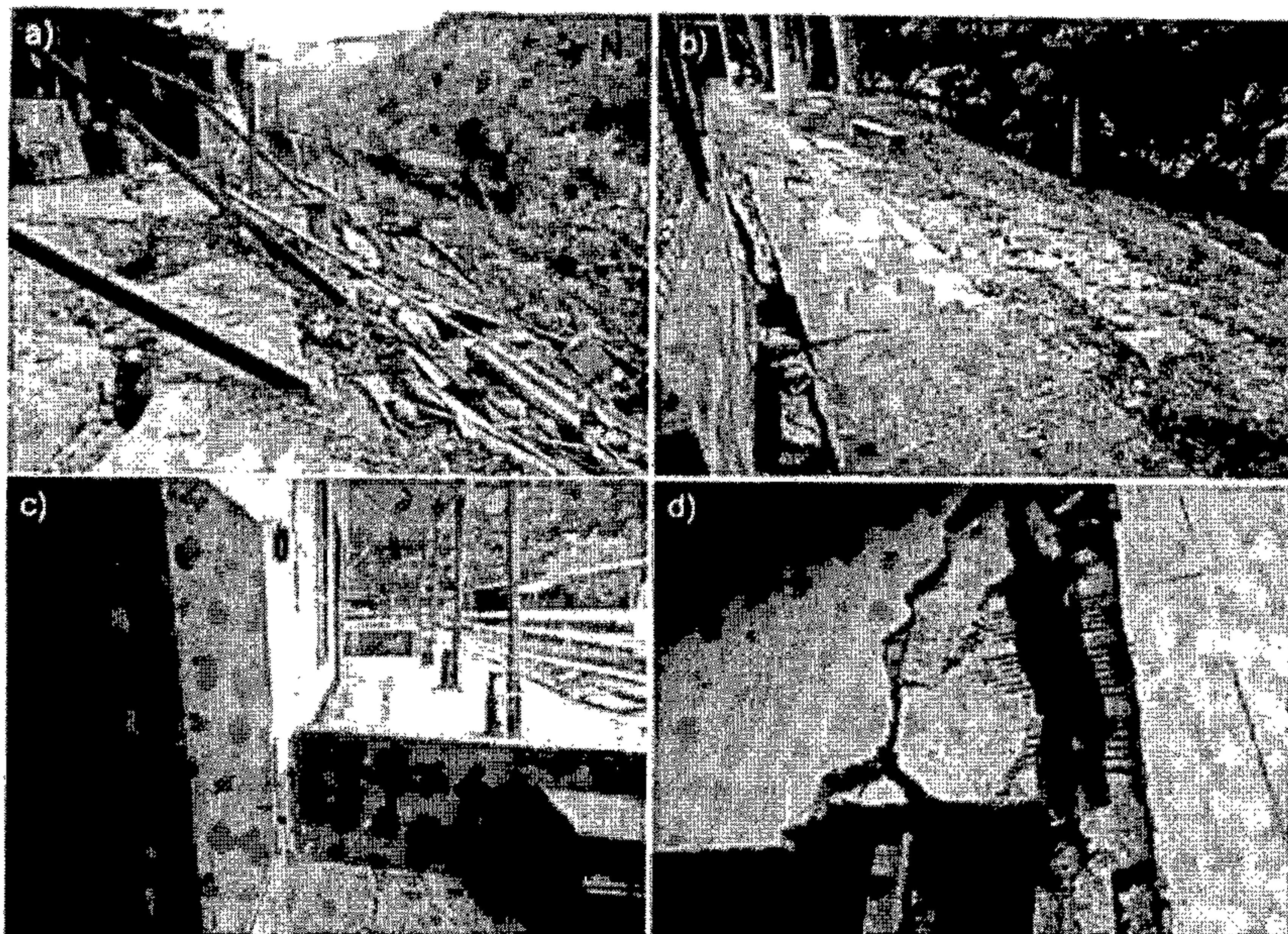
Figura 7: Visita técnica - Afectación por el deslizamiento.
