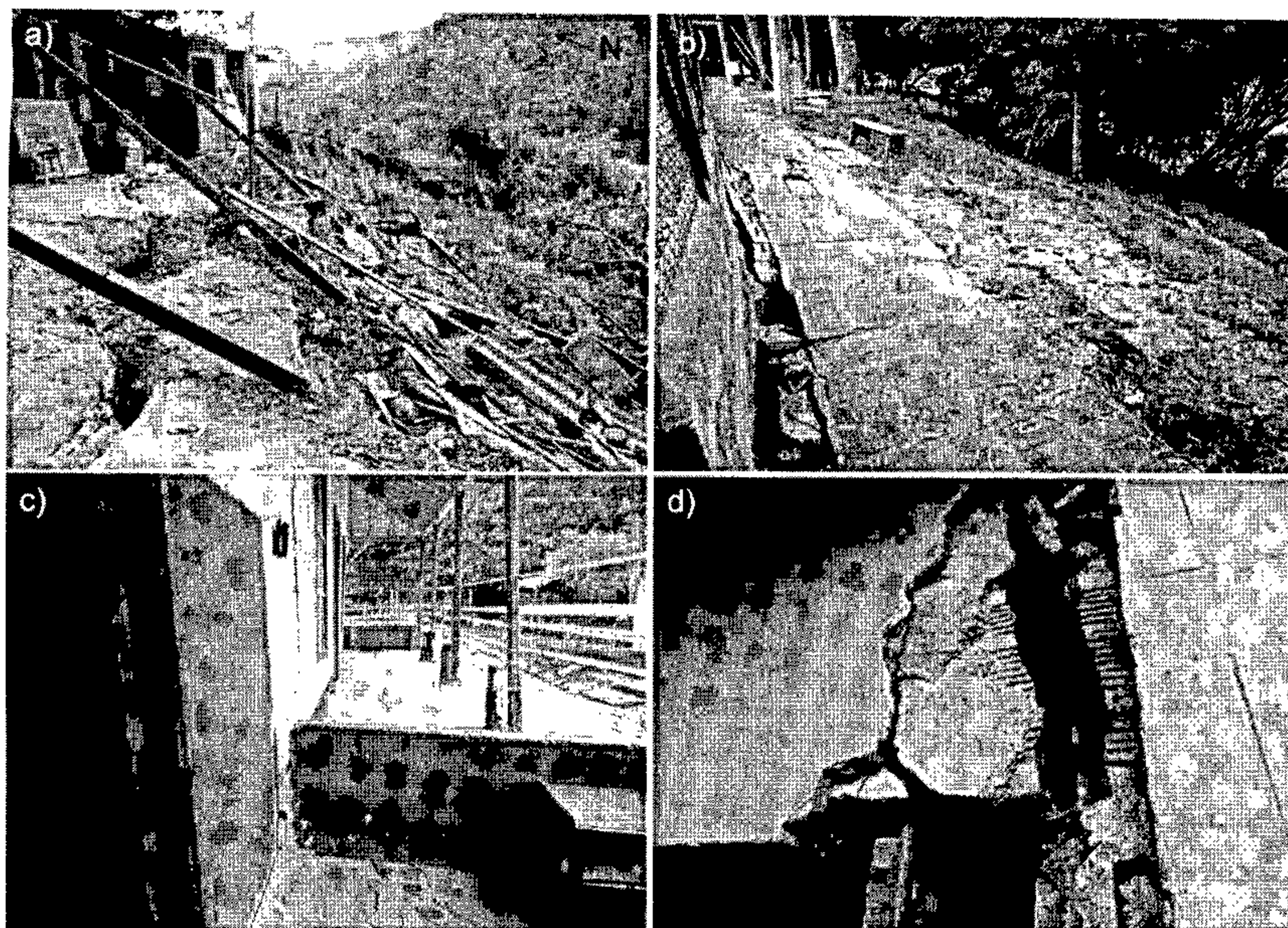
Figura 7: Visita técnica - Afectación por el deslizamiento.
