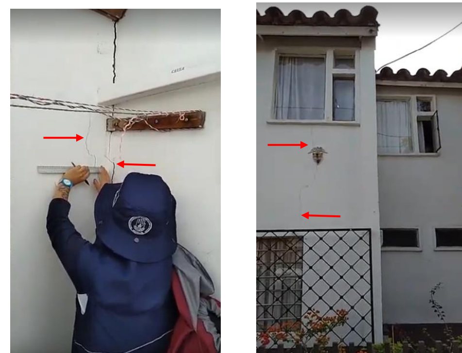
Figura 2. a) Ubicación de testigos sobre las grietas. b) Grieta transversal sobre el muro frontal de una vivienda.
