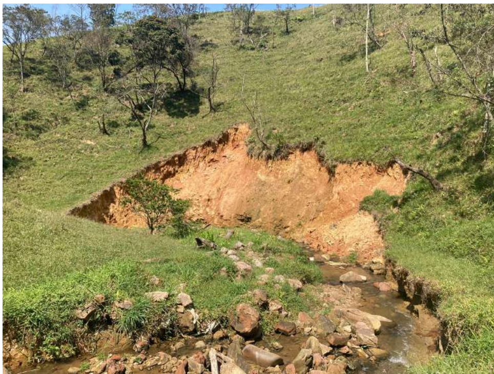
Figura 6: Parte baja del deslizamiento de Andalucía. Visual hecha en campo
