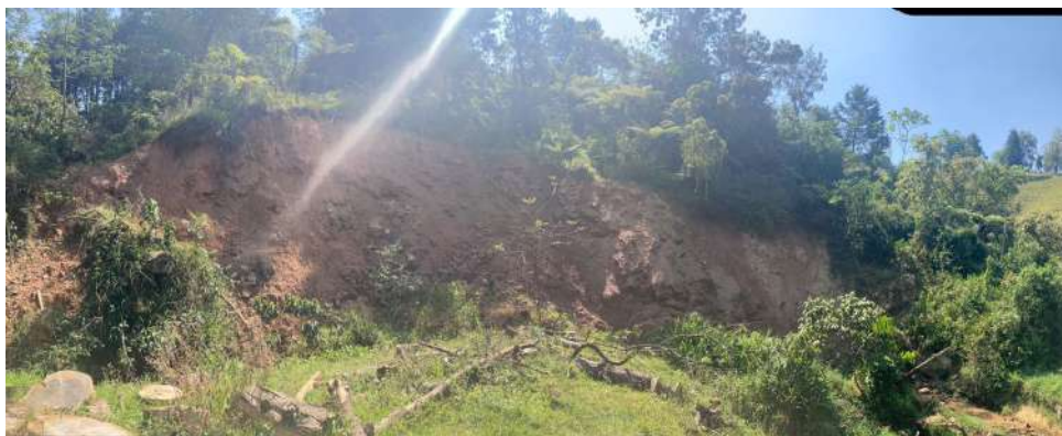
Figura 5: Recorrido realizado el 24 de enero de 2024 en el sector de Andalucía, municipio de Caldas. Parte baja del deslizamiento
