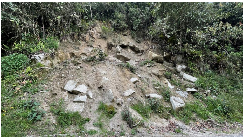
Figura 3. Estado de los deslizamientos en taludes de la vía durante la visita realizada el 10 de noviembre por parte del personal de AMVA-SIATA.
