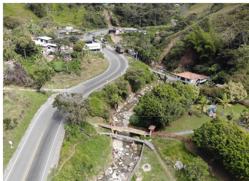
(e) Movimiento en masa en una de las márgenes de la quebrada Cestillal.
