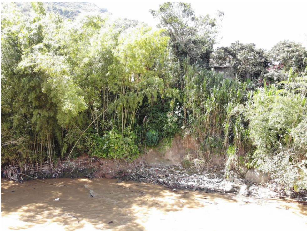
Figura 5. Fotografía panorámica registrada mediante sobrevuelo de drones; sin embargo, la vegetación impide observar las condiciones del talud.
