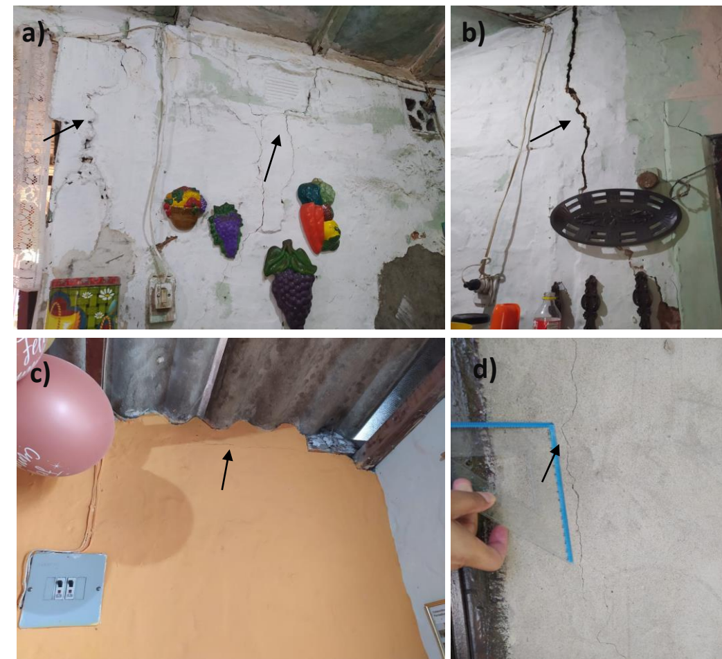
Figura 3. Afectaciones en las viviendas más cercanas al río dónde los habitantes reportan el avance de grietas en los últimos meses (a y b) y la aparición de nuevas grietas desde el último evento de remoción reportado (c y d).
