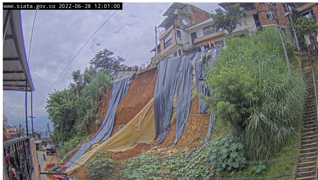
Figura 5: Fotografía registrada el 28 de junio de 2022. Se evidencia parte de la lona de plástico deteriorada y con material del depósito desplazado hacia la vía.
