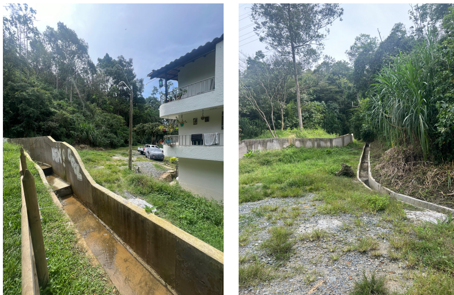
Figura 19: Fotografías tomadas el 18 de junio de 2024. Se observan obras de mitigación que consisten en un muro de impacto y un canal de conducción hidráulica donde se evidenció un flujo constante de agua sin evidencias de colmatación al momento de la visita
