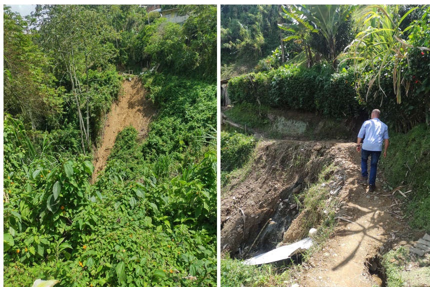
Figura 10: Fotografías tomadas en septiembre de 2022. Fotografía izquierda, flujo de lodos - deslizamientos superficiales en otras secciones de la cuenca. Fotografía derecha, deslizamiento superficial con pérdida de suelo de soporte del sendero peatonal.
