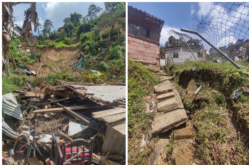
Figura 9: Fotografías tomadas en septiembre de 2022. Fotografía izquierda, escombros de colapso total de edificación residencial por deslizamiento rotacional. Fotografía derecha, deformaciones del terreno y estructuras antrópicas por deslizamiento rotacional.
