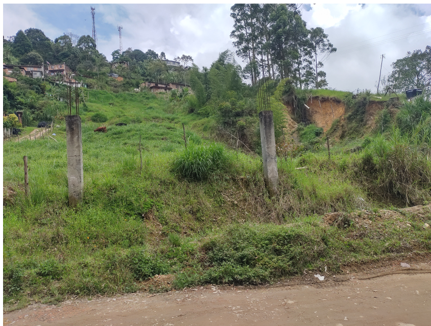
Figura 3: Deslizamiento Salinas en el mes de septiembre de 2022. El escarpe de deslizamiento ubicado a la derecha de la imagen no corresponde al evento de junio de 2019; sin embargo, se considera un posible escenario de riesgo debido a sus características y a la presencia de flujos de aguas residuales.
