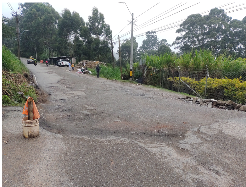
Figura 6: Deformaciones en la vía vehicular asociadas al deslizamiento monitoreado. Fotografía registrada el 17 de abril de 2023.
