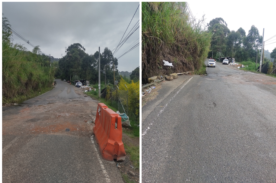
Figura 5: Deformaciones en el tramo de la vía vehicular monitoreado. Fotografía registrada el 20 de septiembre de 2022.
