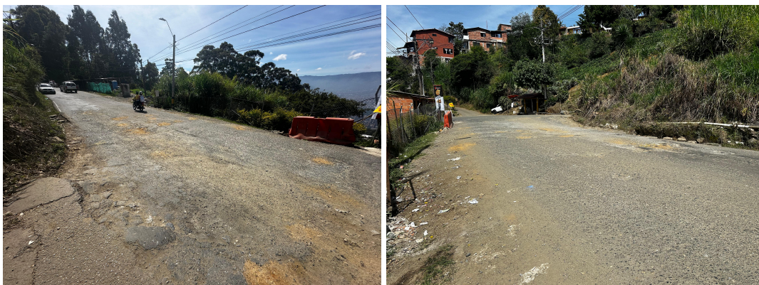
Figura 8: Irregularidad en el terreno en el tramo de la vía vehicular monitoreado. Fotografía registrada el 16 de julio de 2024.
