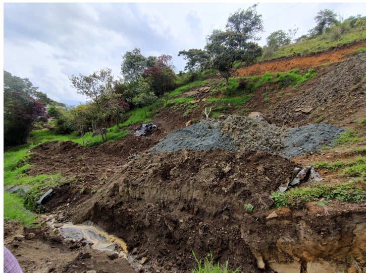
Figura 11: Intervenciones de la corona principal del movimiento en masa. Visita realizada el 20 de abril de 2023.
