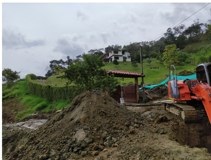
Figura 12: Intervenciones de la corona principal del movimiento en masa. Visita realizada el 20 de abril de 2023.
