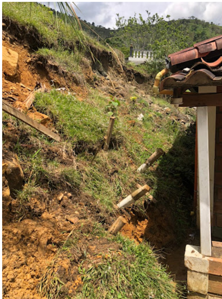
Figura 8: Deslizamiento superficial en talud adyacente a edificación residencial. Fotografía registrada en junio de 2021. Esta zona había manifestado agrietamientos previamente, como se observa en la Figura ??
