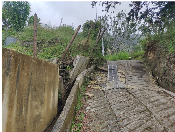
Figura 10: Afectaciones en muro de contención y vía vehicular. Obstrucción parcial del canal del arroyo que atraviesa el deslizamiento. Foto de septiembre de 2022.
