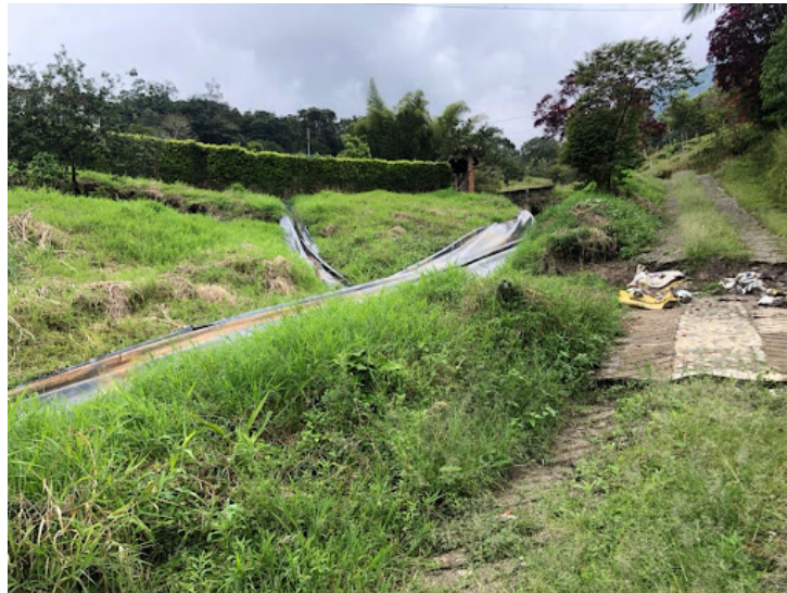
Figura 9: Obras de drenaje en el cuerpo del deslizamiento, también se observan deformaciones en la vía vehicular. Fotografía registrada el 10 de septiembre de 2021.
