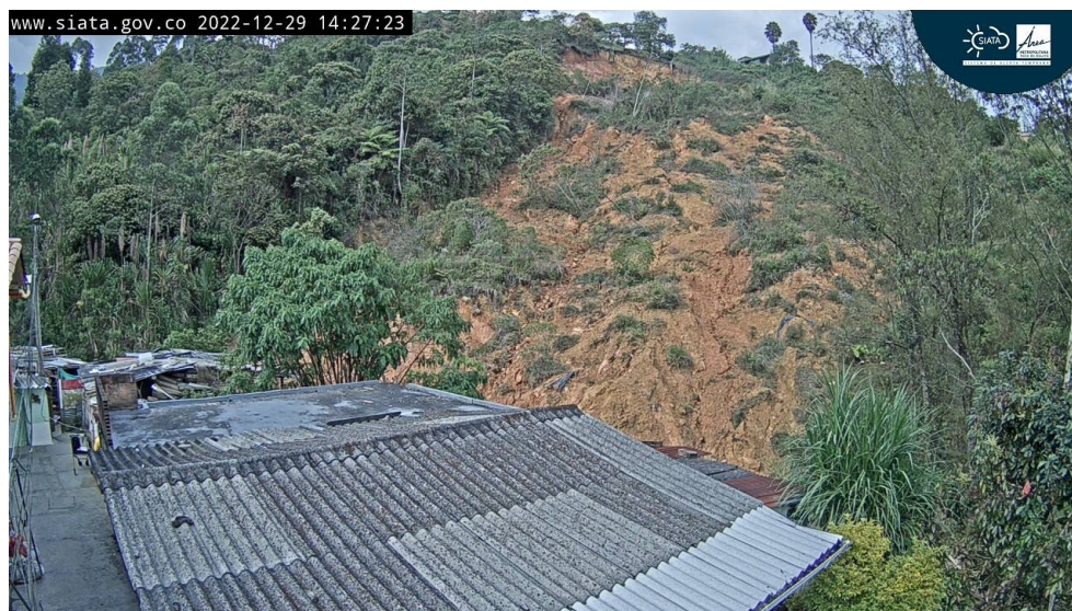
Figura 8: Fotografías de la cámara de monitoreo del deslizamiento. Fotografía registrada el 29 de diciembre de 2022. Se observa la evolución del deslizamiento, avance de la corona, caída de árboles y procesos activos de erosión superficial en el cuerpo del deslizamiento (surcos).
