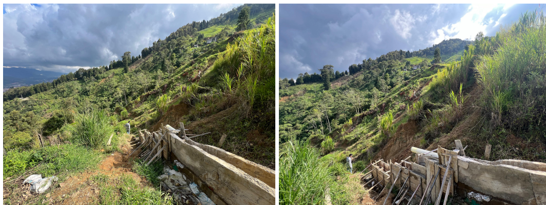
Figura 22: Fotografías tomadas en sitio el 26 de junio de 2024. Se evidencian obras hidráulicas de manejo de aguas superficiales construidas con deficiencias estructurales y con filtraciones en la losa de concreto.
