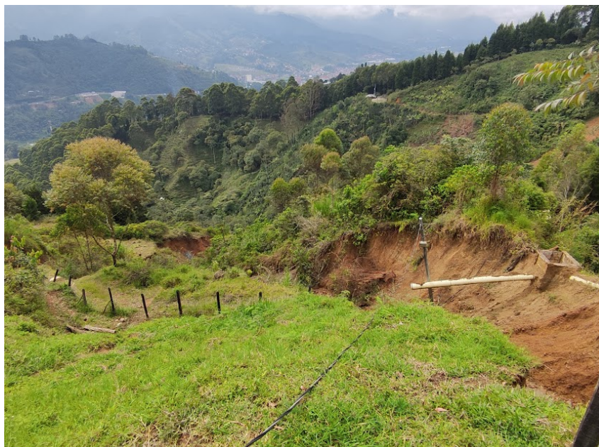
Figura 14: Fotografía de la cárcava desde la parte alta de la microcuenca. Nótese la caja de concreto que hace parte de las obras de manejo y captación de aguas superficiales realizadas en 2017. Fotografía registrada el 19 de septiembre de 2022.
