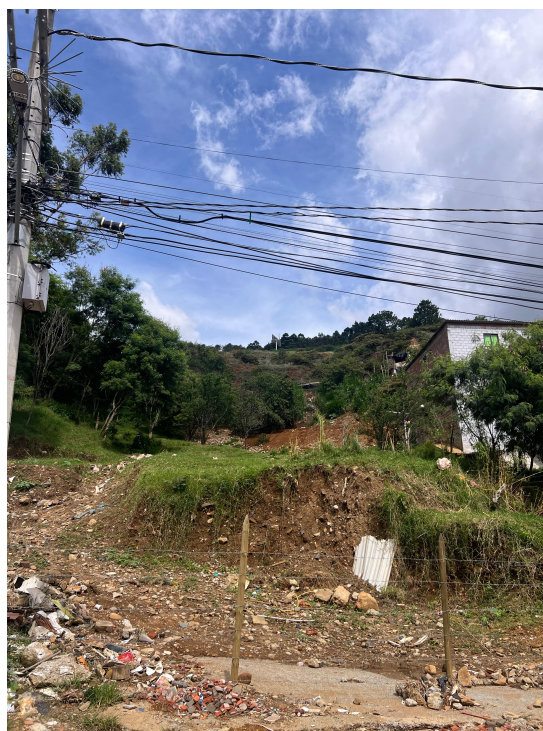
Figura 10: Fotografías registradas en visita de monitoreo el 11 de junio de 2024 sobre la zona de depósito del deslizamiento. No se observa la vivienda registrada en el monitoreo con cámaras sobre el cuerpo del deslizamiento. Se evidenció depositación de material antrópico sobre todo el lugar.
