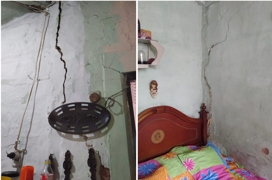
Figura 2: Grietas y humedades en la edificación residencial visitada.
