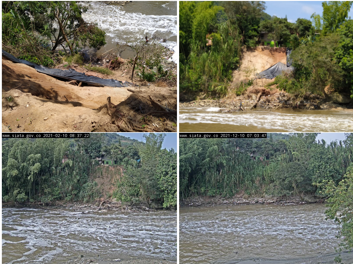
Figura 5: Evolución del movimiento en masa monitoreado en el sector El Hatillo. Izquierda superior, fotografía del talud desde la cabeza de este; derecha superior, movimiento en masa en agosto 8 de 2020; inferior izquierda, cámara de monitoreo febrero 10 de 2021; inferior derecha, cámara de monitoreo diciembre 10 de 2021.
