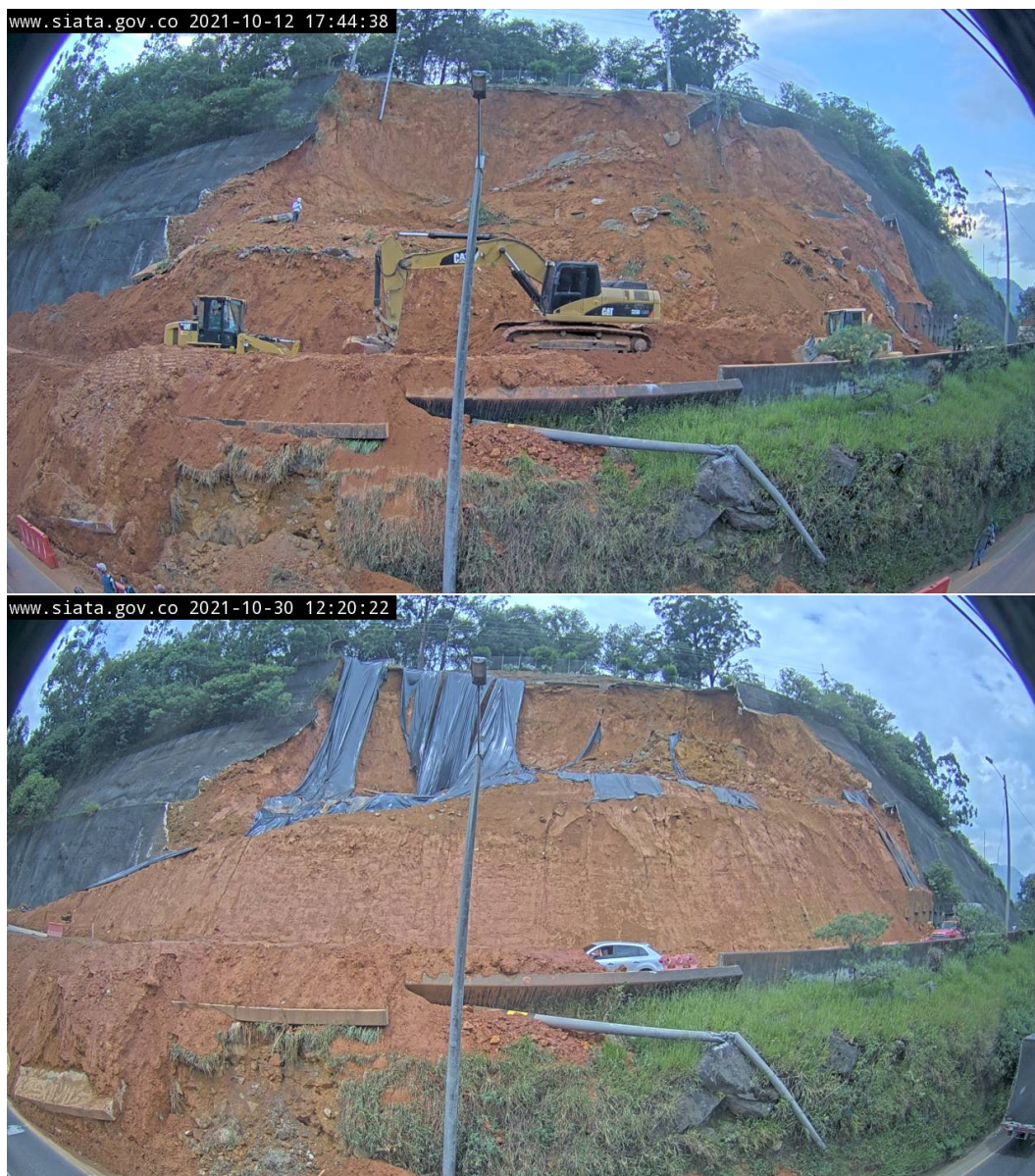
Figura 7: Fotografías de la cámara de monitoreo del deslizamiento. Fotografía superior registrada en octubre 12 de 2021 y la fotografía inferior registrada en octubre 30 de 2021. En la imagen superior se observa el material movilizando obstruyendo la calzada Girardota-Copacabana. En la imagen inferior se observa habilitación de calzada, terraseo del material movilizado, colapso de sección de la vía en la parte alta del talud y otros elementos de concreto.
