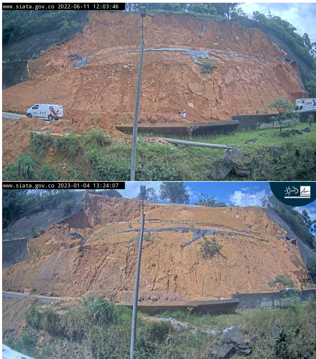
Figura 8: Fotografías de la cámara de monitoreo del deslizamiento. Fotografía superior registrada en junio de 2022 y la fotografía inferior registrada el 4 de enero de 2023. En la imagen superior se observan surcos producto de erosión pluvial en el material movilizado y caída de suelo desde la parte alta del talud. En la imagen inferior se observan intervenciones asociadas con la recuperación de la vía ubicada sobre el talud, continúan los procesos de erosión pluvial sobre el material depositado.
