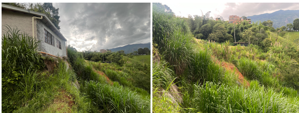
Figura 12: Fotografías en sitio. Registradas el 18 de junio de 2024. Se observa vivienda sobre el escarpe del deslizamiento con desgaste en el concreto lanzado. Se evidencia recuperación parcial de la cobertura vegetal.
