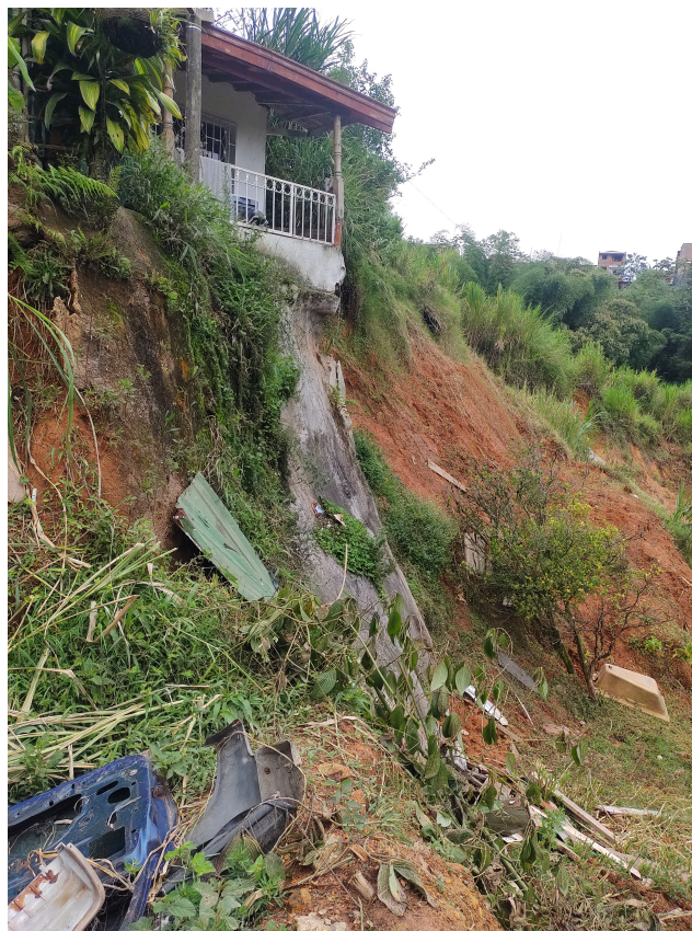
Figura 2: Edificación residencial con pérdida de suelo de soporte ubicada sobre la corona del deslizamiento.
