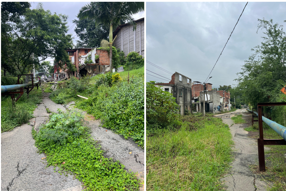
Figura 5: Fotografía izquierda y derecha tomadas el 11 de junio de 2024 a las edificaciones residenciales y vía principal del barrio Ancón Norte. Fotografía derecha tomada a las edificaciones residenciales colapsadas con deterioro y vía vehicular deformada en el barrio Ancón Norte, al momento de la visita se evidencia recuperación de la cobertura vegetal de manera parcial en sitio.
