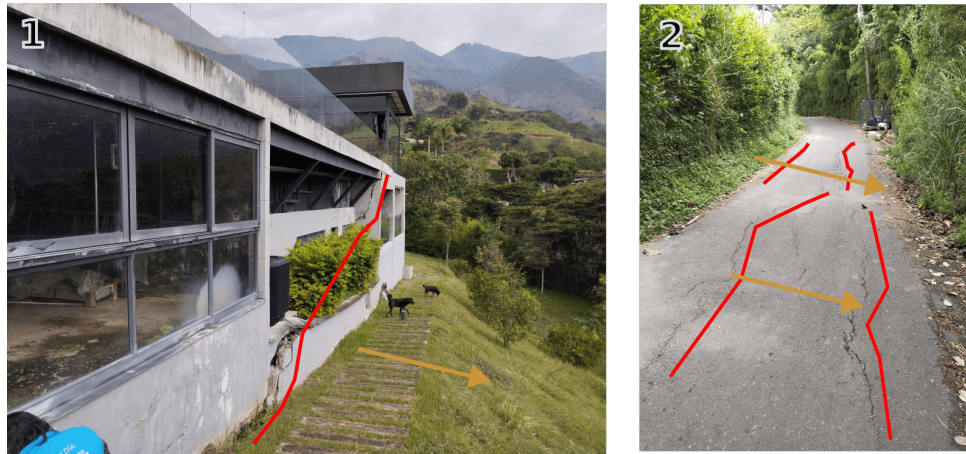
Figura 2.21: Evidencias de inestabilidad del terreno en la zona A. Fotografía 1, agrietamientos en edificación residencial. Fotografía 2, agrietamientos en vía vehicular.
